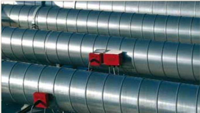
Установка удаления пыли со смонтированными датчиками
